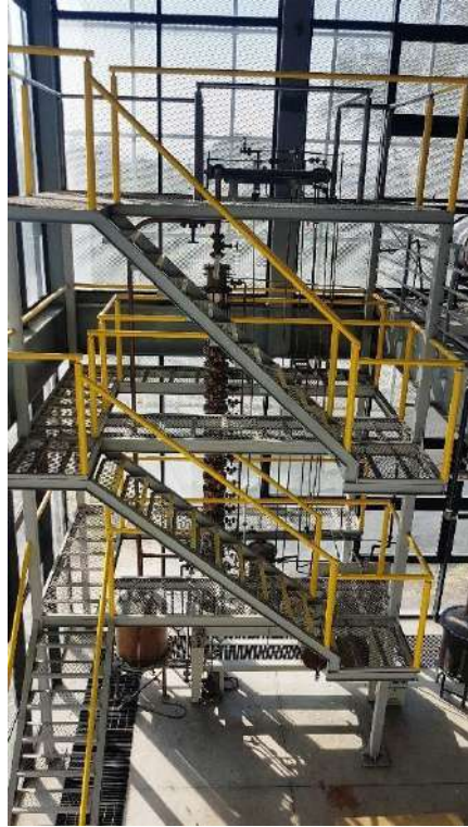
Imagen 1. Columna de destilación fraccionada (zona de procesos de separación del LIQ)
