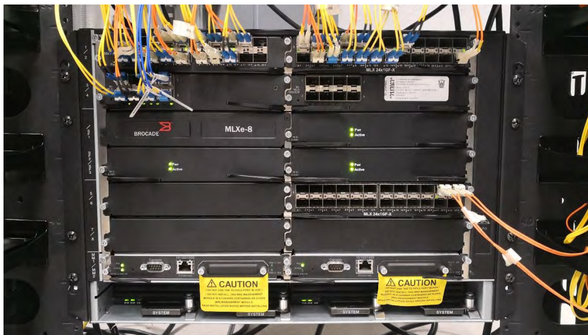
Fotografía 1. Equipo central (Core) de la red de datos de CUCEI
