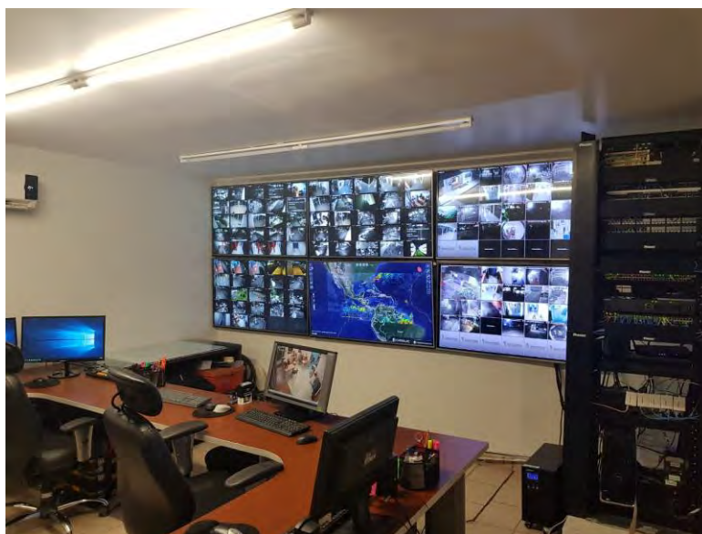
Fotografía 1. Centro de Coordinación, Control y Comunicaciones CUCEI “c4”
